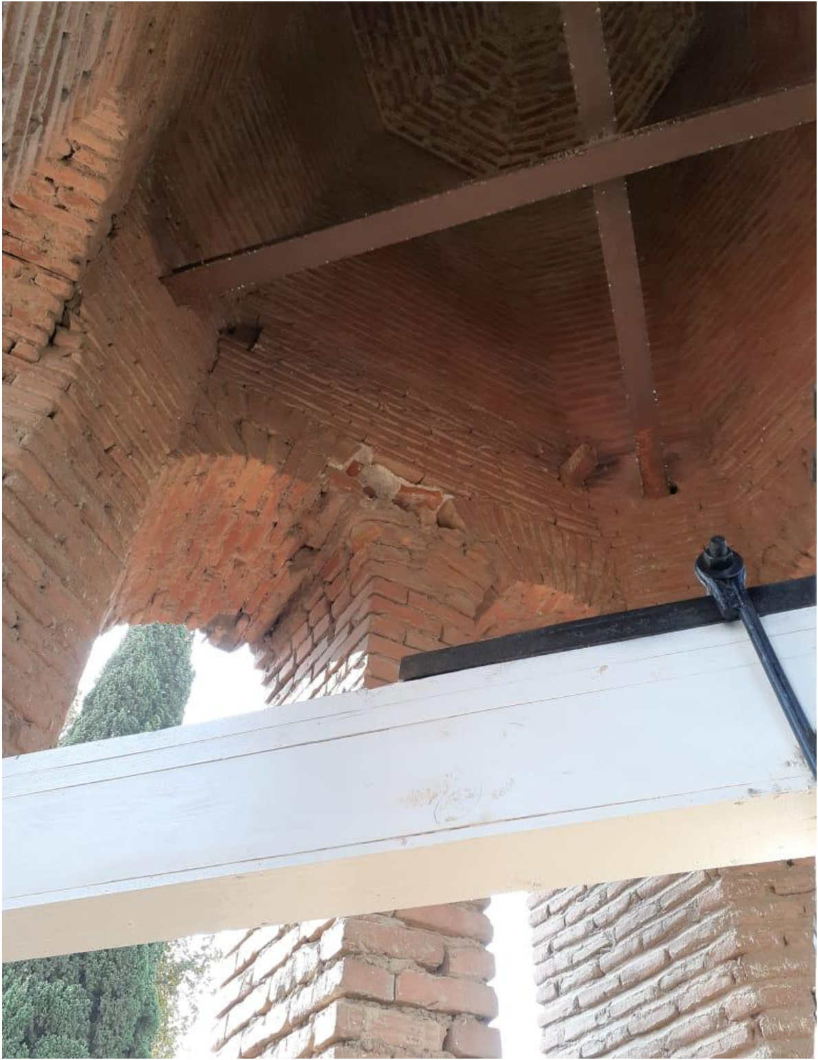
Şəkildə Ermənistan silahlı qüvvələrinin ballistik raket atəşi nəticəsində tarixi-dini abidənin fasad hissəsində yaranmış zədələr öz əksini tapmışdır.
