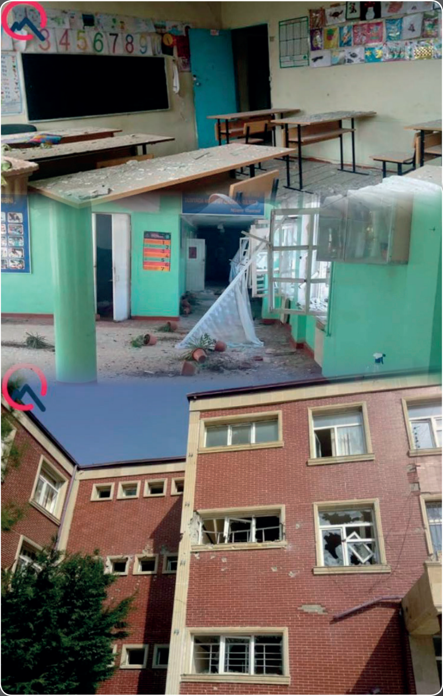
Yapılan saldırılarda hasar gören okullar
